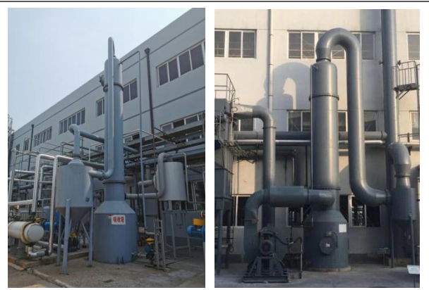
车间废气水喷淋过滤塔
