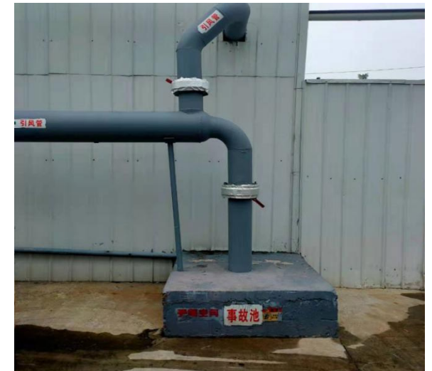
事故应急池防止污水泄漏
