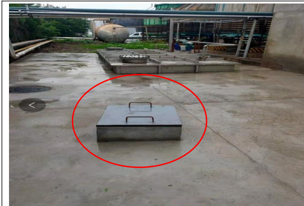
污水排水提篮式过滤器及集水池
