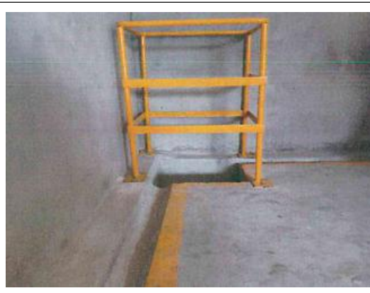
危废收集明渠及收集槽
