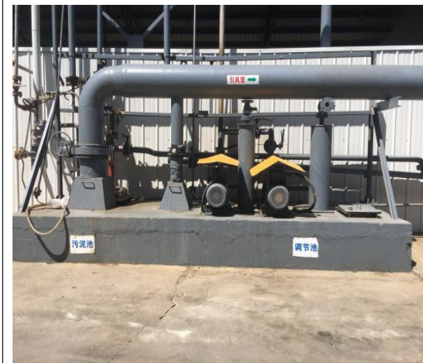
调节池及污泥池
